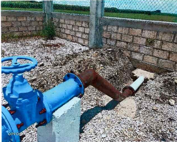
Equipamiento de pozo profundo, Segunda Etapa, Ranchería el Calvario
